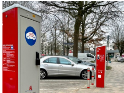
Aufstellung von E-Lade-Säulen
